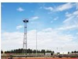
POSTES DE GRAN ALTURA
